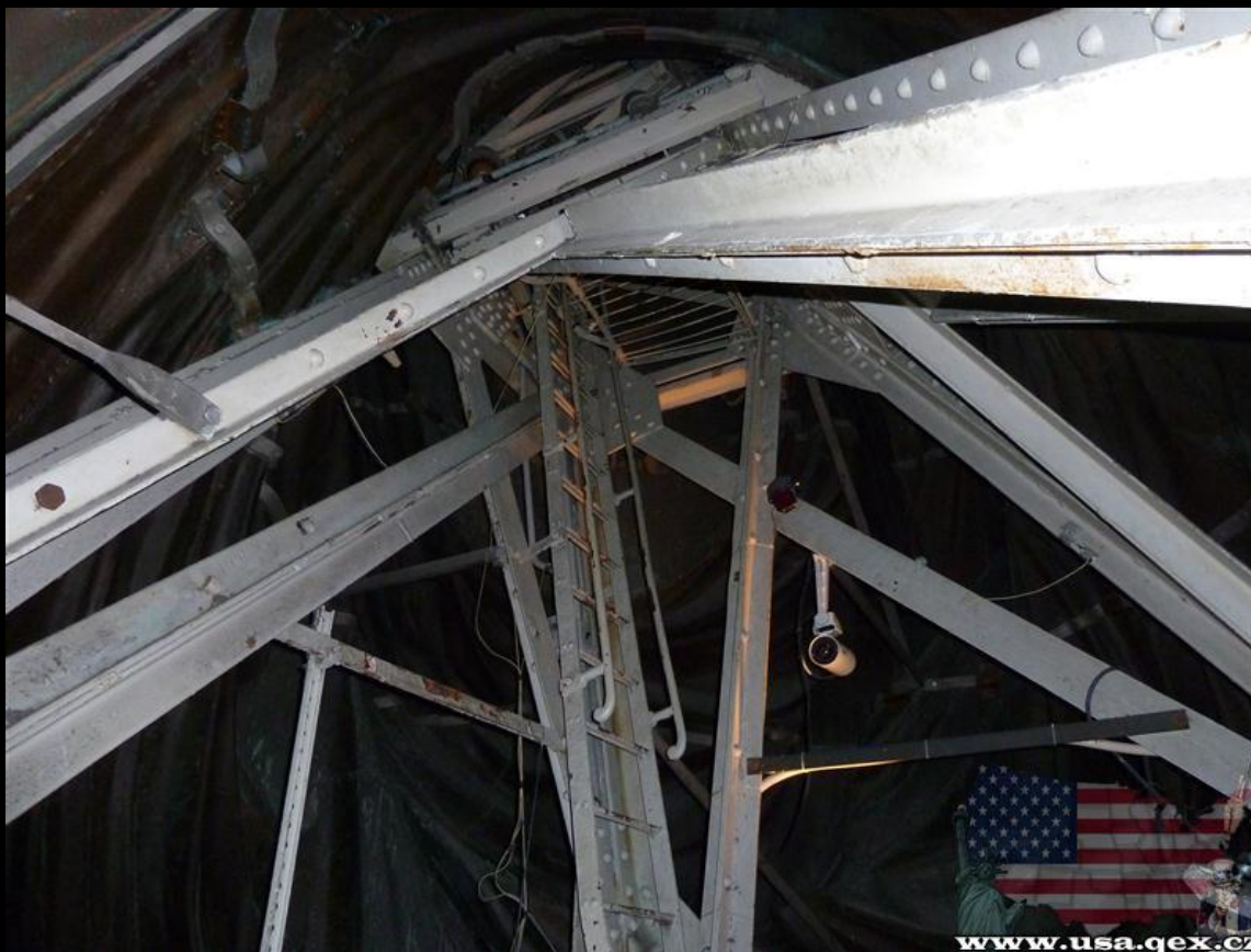
Koroze nosné konstrukce Sochy Svobody
